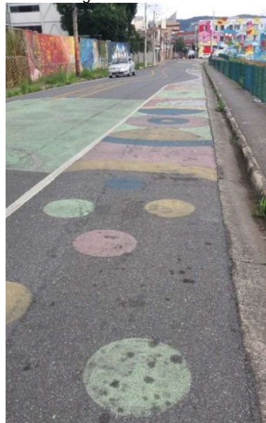
Figura 57: Pinturas apagadas e altas velocidades de tráfego na rua Diamantina
