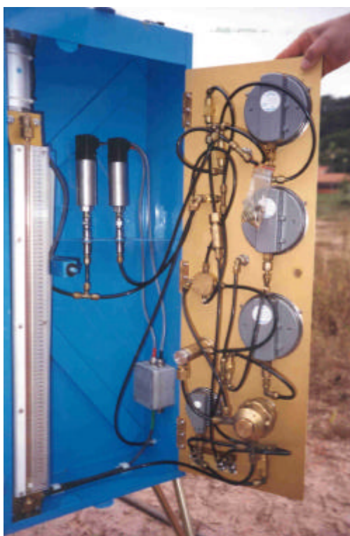
Figura 3.9 – Visão interna da caixa de monitoramento do equipamento fabricado pela APAGEO SEGELM, com aquisição automática de dados.
