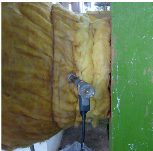
Figura 19 – Sonda de medição dos gases de combustão inserida no ponto central na saída da câmara de combustão.
