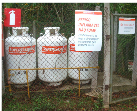
Figura 17 – Tanque P-190 com o combustível GLP.
