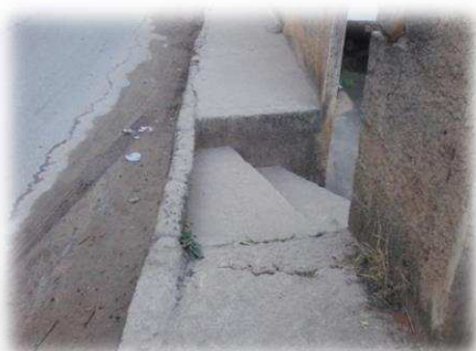
(C): Piso da calçada interrompido por mudança de nível
