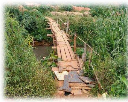
(B): Ponte de ligação entre os Bairros Cidade Nova e São José
