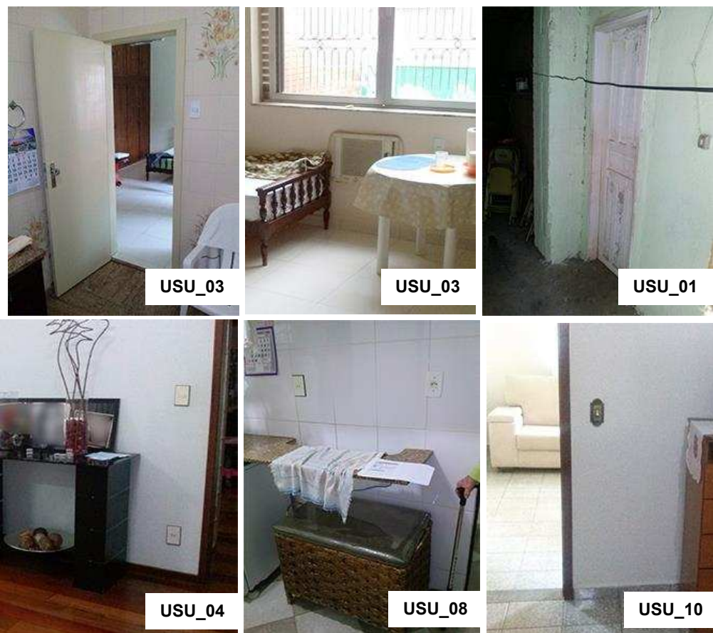
Figura 43 - Tomadas, interruptores e ar condicionado Fonte: Acervo do autor, (2015)
