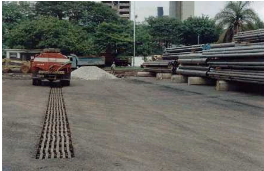
Figura 18 – Pátio da empresa Vallourec & Mannesmann em Belo Horizonte, poucos dias após a estabilização de 15 cm da camada de base com RBI Grade 81
