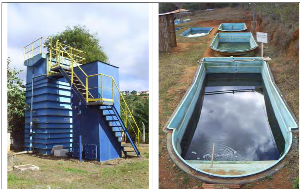
Figura 4.1 - ETE Viçosa, Viçosa, MG – vista do sistema UASB + BF (à esquerda) e série experimental de lagoas (à direita)
