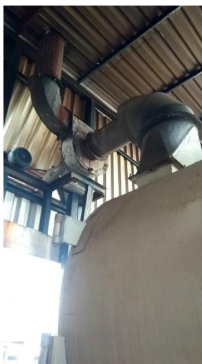
Figura 18 – Saída dos gases resultantes da combustão da biomassa
