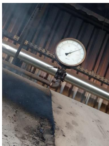
Figura 16 – Manômetro de saída de vapor
