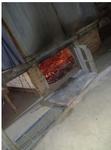
Figura 17 – Saída das cinzas resultantes da queima do combustível na ante fornalha
