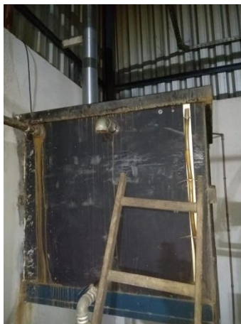
Figura 19 – Reservatório de água de alimentação da caldeira
