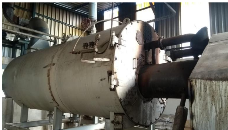
Figura 14 – Vista do corpo da caldeira do Laticínios Lindo Vale São Geraldense
