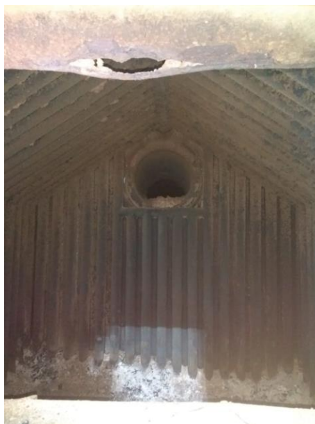
Figura 13 – Ante fornalha com grelha aquatubular
