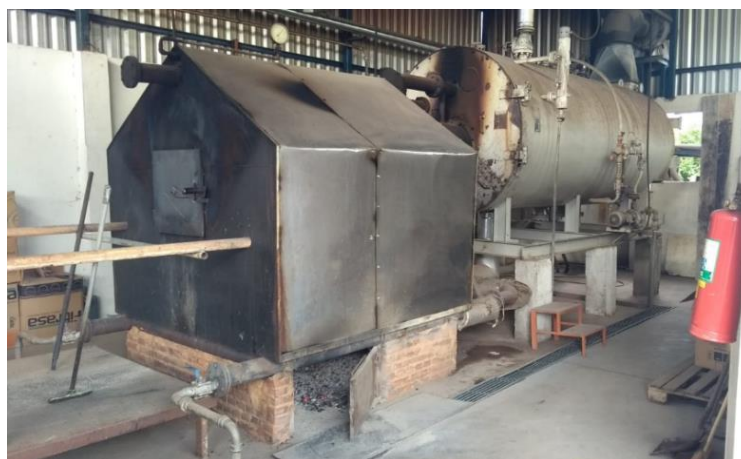
Figura 10 – Vista lateral da caldeira do Laticínios Lindo Vale São Geraldense
