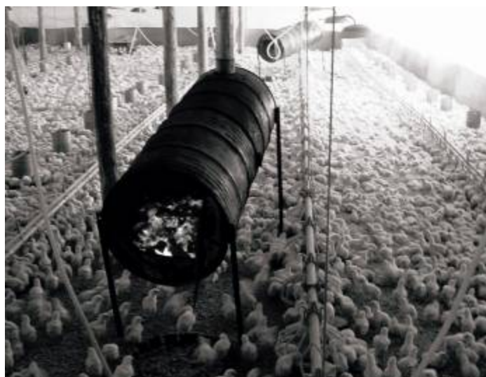
FIGURA 5. Vista geral dos tambores de aquecimento por radiação ao longo do galpão
