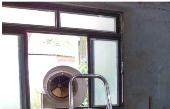
Figura 3 -Instalação de equipamento de exaustão.
