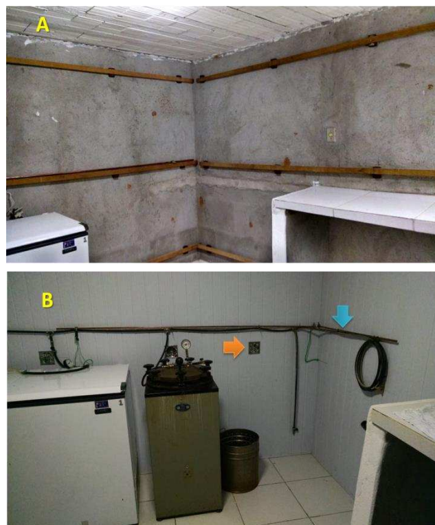
Figura 4 - Produção do sistema de exaustão. A- Instalação de forro de PVC, afastado 5 cm nas paredes interligado ao equipamento de exaustão. B- Válvulas de distribuição do sistema de exaustão (seta laranja), sistema de aterramento (seta azul).
