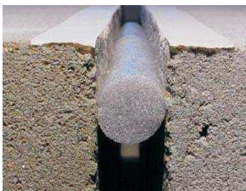
Figura 13 – Detalhe do posicionamento do delimitador de profundidade tipo Tarucel® em uma junta.
