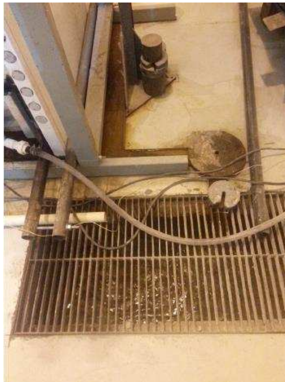
Figura 30 – Saídas da água de resfriamento junto ao painel radiante.
