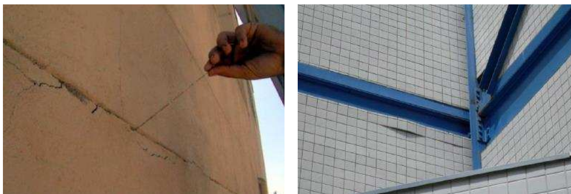
Figura 9 – Exemplos de manifestações patológicas: a) descolamento do silicone de juntas de movimentação horizontal; b) estufamento do revestimento cerâmico aplicado sobre elementos metálicos que promovem desvinculação do fechamento vertical.
