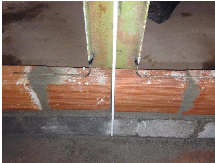
Figura 52 – Detalhe da colocação dos grampos nas juntas horizontais de argamassa da alvenaria.
