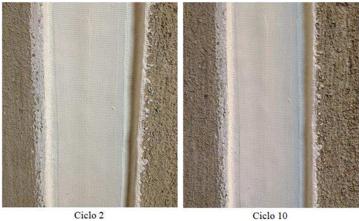
Figura 103 – Detalhe do tratamento com manta de elastômero EPDM após aquecimento do modelo experimental PAR-JV-R1, na região B indicada.
