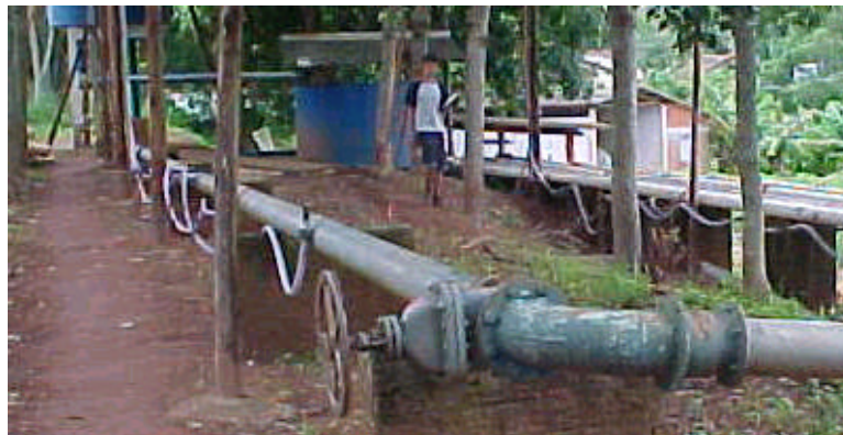
Figura 7 – Tubulação fixa de ferro galvanizado de 155,58 mm, com a válvula de gaveta para controle de vazão
