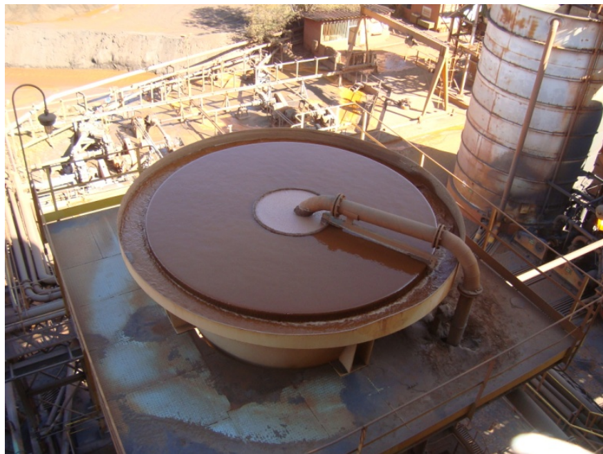
Figura 3.6: Vista superior do cone desaguador do rejeito de separação magnética
