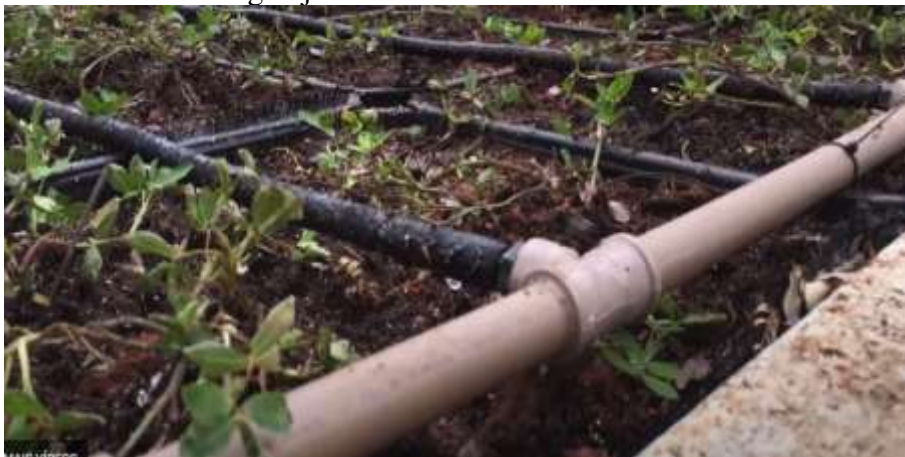
Figura 32 - Sistema de gotejamento
