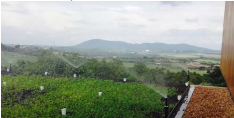
Figura 33 - Sistema de aspersão sobre telhado verde
