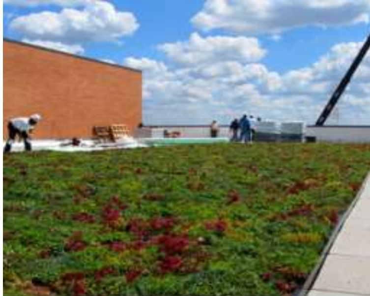
Figura 14 - Sistema de telhado verde extensivo sobre uma laje em Chigago, USA
