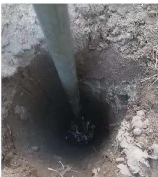
Figura 31 - Poços de coleta de água.
