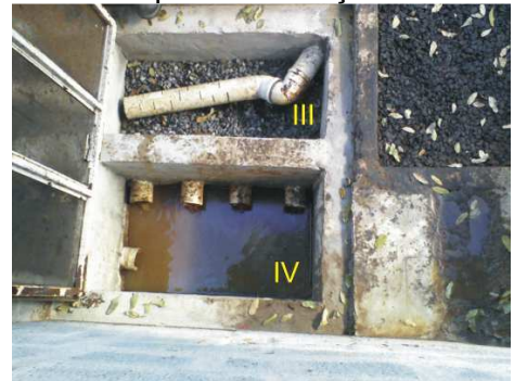
F – Filtro de brita (III) e saída (IV) da ETE
