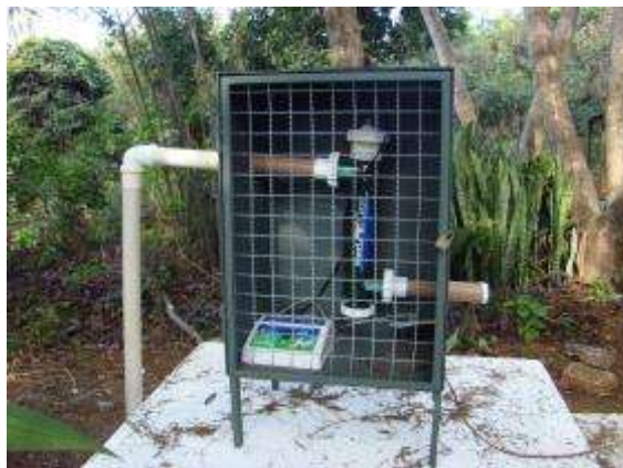
Figura 14 - Dispositivo de desinfecção ultravioleta.
