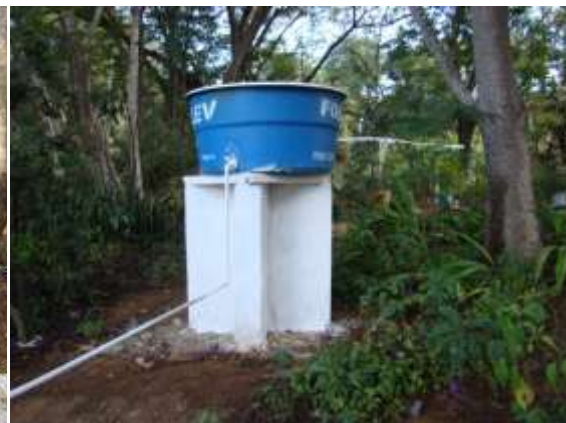
Figura 15 - Reservatório para armazenamento do efluente tratado.
