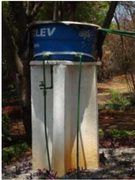
Figura 12 - Reservatório para equalização da vazão afluente ao filtro anaeróbio.
