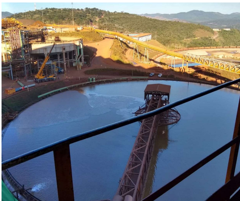
Figura 5.1 - Espessador de lamas da mina de Brucutu
