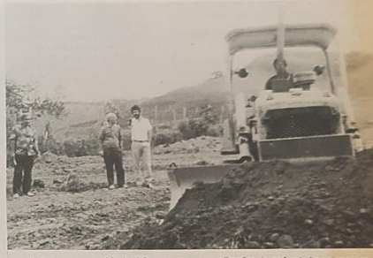
Ao fundo, o empresário José Chequer ouve as explicações do topógrafo Ary sobre a terraplanagem
