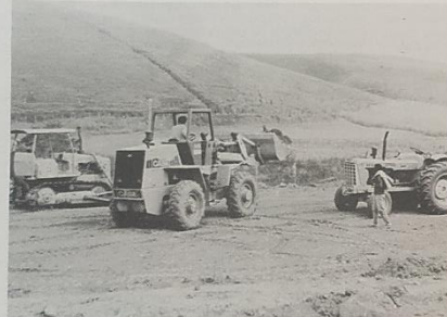
As máquinas da Cotegej estão trabalhando a todo vapor na área de construção do clube
