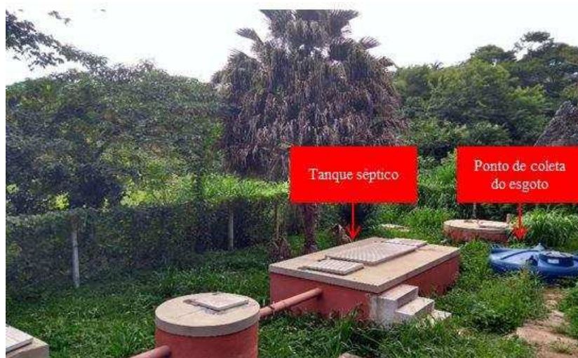
Figura 6.1 - ETE localizada no bairro Romão dos Reis, em Viçosa – Minas Gerais.
