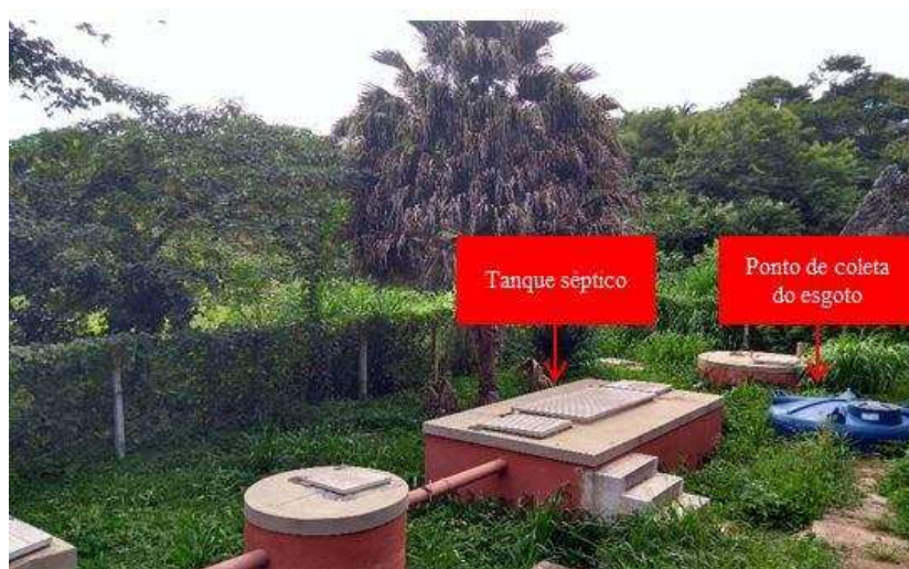
Figura 5.1 - ETE localizada no bairro Romão dos Reis, em Viçosa – Minas Gerais.
