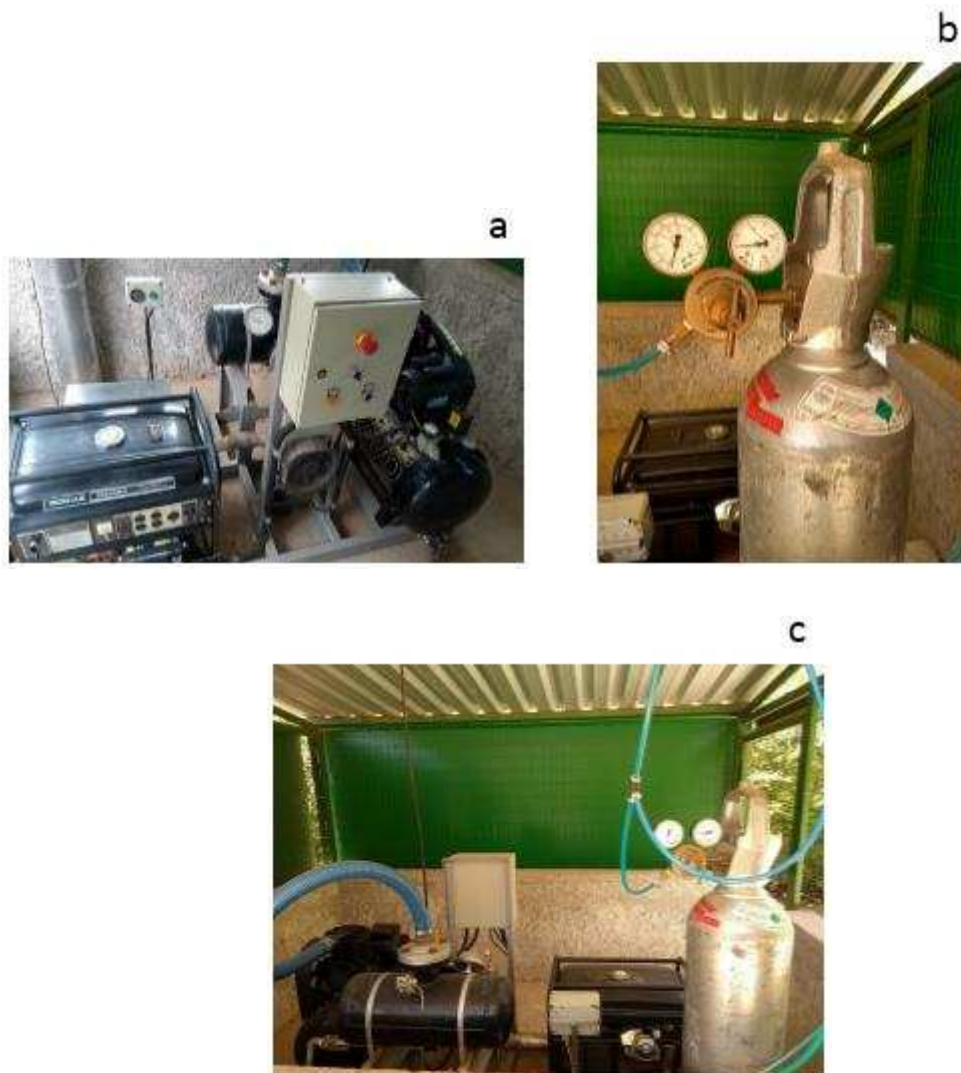
Figura 5.3 - (a) Gerador de energia elétrica utilizado para gerar o gás de emissão e compressor para armazenamento do gás (b) Cilindro de gás com CO 2 em elevada concentração (99,9%) e (c) Sistema de controle dos gases.
