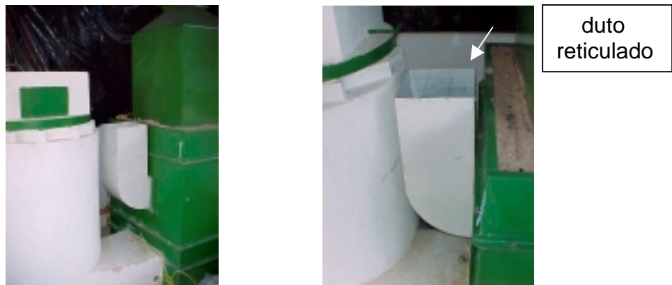
Figura 47 - Duto para medição da velocidade do ar na entrada da câmara de combustão.
