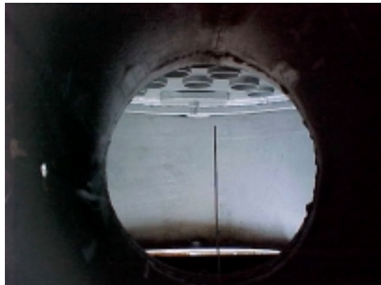
Figura 61 - Sensor de temperatura instalado na entrada da chaminé.
