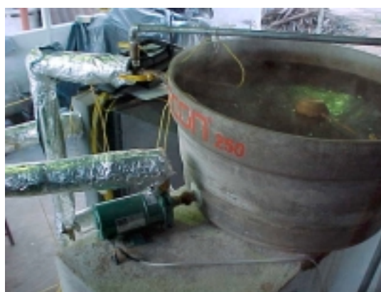
Figura 57 - Reservatório e bomba de alimentação da caldeira.
