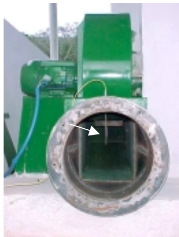
Figura 42 - Posicionamento da sonda de medição da temperatura do ar aquecido na saída do ventilador.
