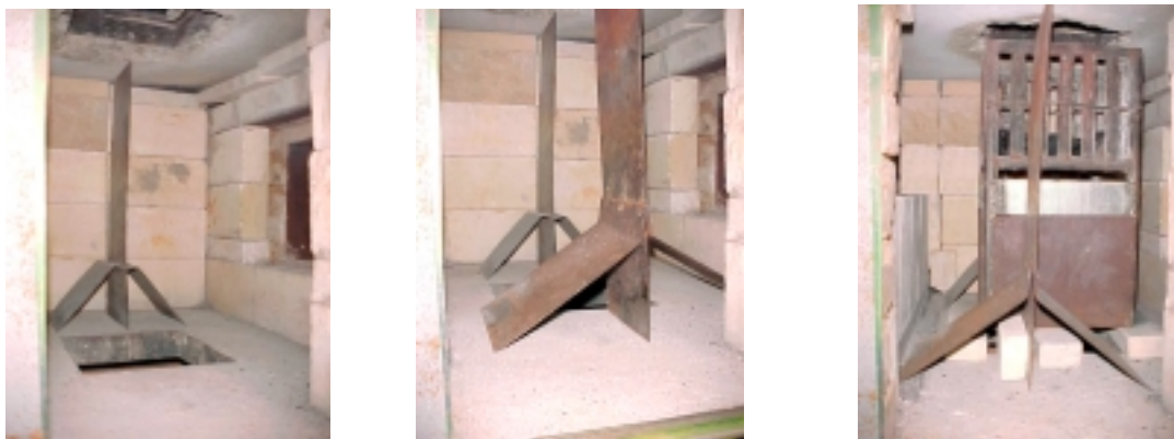
Figura 75 - Posicionamento dos aparadores (defletores) no interior da câmara de combustão, ao lado da célula de queima C1.
