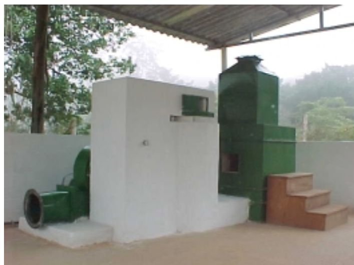
Figura 33 - Vista geral da fornalha acoplada ao ventilador e ao ciclone.
