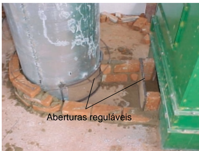
Figura 25 - Registros situados na saída dos gases da fornalha para controle da admissão de ar primário na câmara de combustão, e no ciclone, para regulagem da velocidade dos gases.
