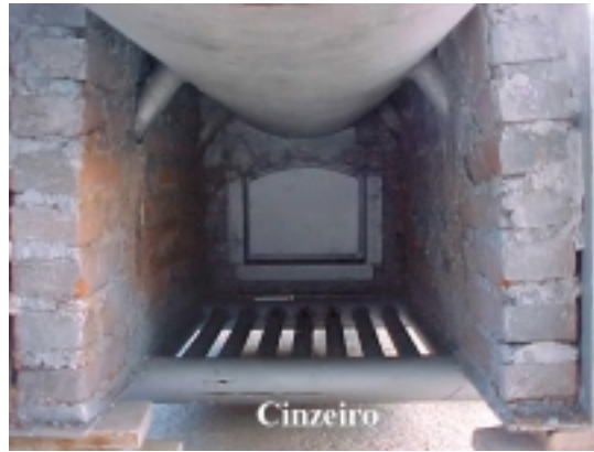
Figura 53 - Câmara de combustão da fornalha interna.
