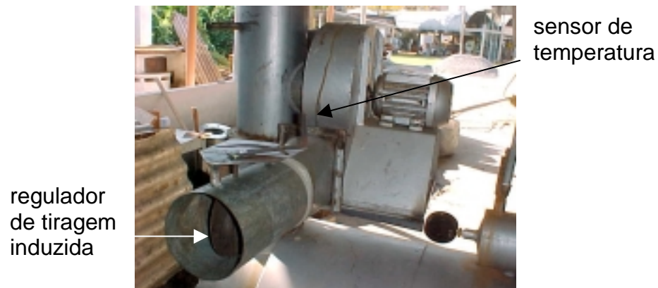
Figura 58 - Aspirador de fuligem instalado na base da chaminé e sensor para medição da temperatura dos gases de escape.
