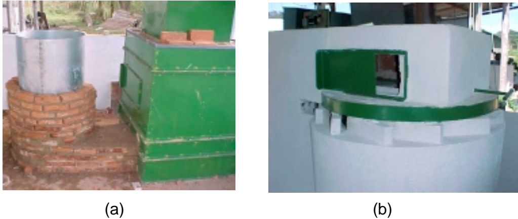
Figura 29 - Construção do ciclone. (a) Fôrma metálica para facilitar o assentamento e alinhamento dos tijolos. (b) Aberturas tangenciais para entrada de ar no ciclone e abertura lateral para regulação da temperatura do ar aquecido.
