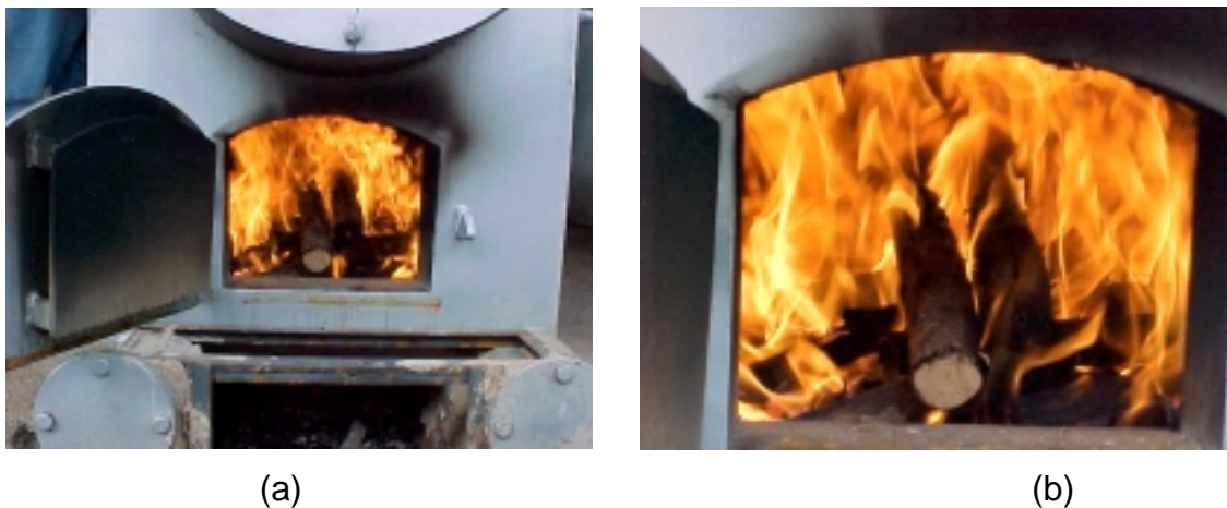
Figura 4 - (a) Combustão da lenha na fornalha interna de uma caldeira. (b) Vista em detalhe mostrando a queima de voláteis.
