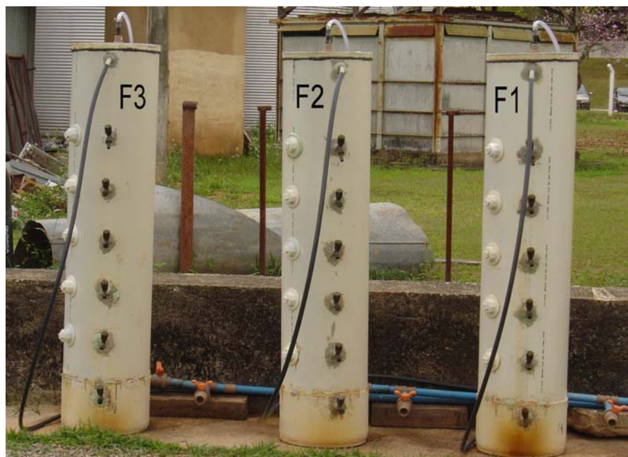
Figura 2.2. Vista dos filtros anaeróbios.
