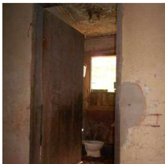
Figura 37: Banheiro improvisado no lugar de um quarto, Piranga, MG. Fonte: A aposentadoria rural e as mudanças nos modos de vida dos idosos (2013).
