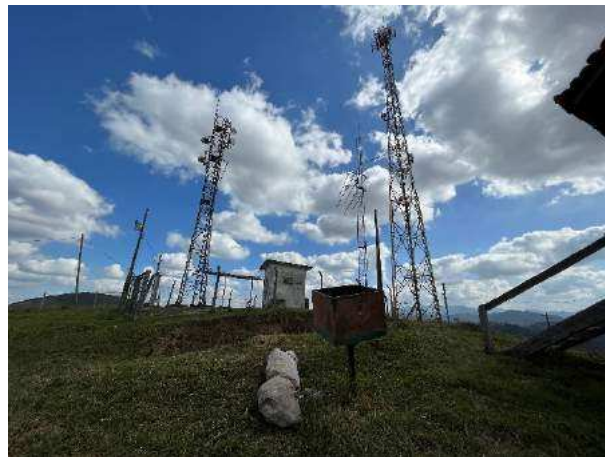
Figura 195 – Antenas de comunicações no Mirante
