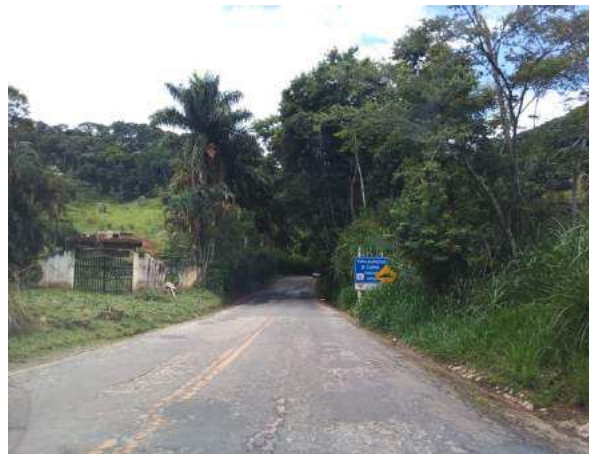
Figura 30 – Buracos na rodovia
