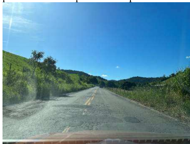
Figura 36 – Trecho da AMG-2930, com problemas de recapeamento da pista
