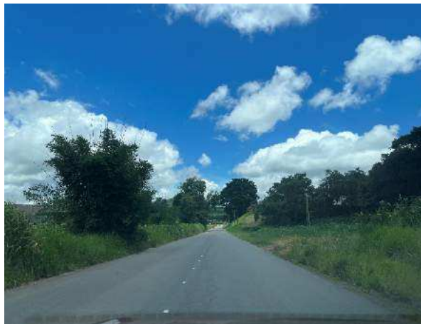
Figura 40 – Trecho sem sinalização horizontal
