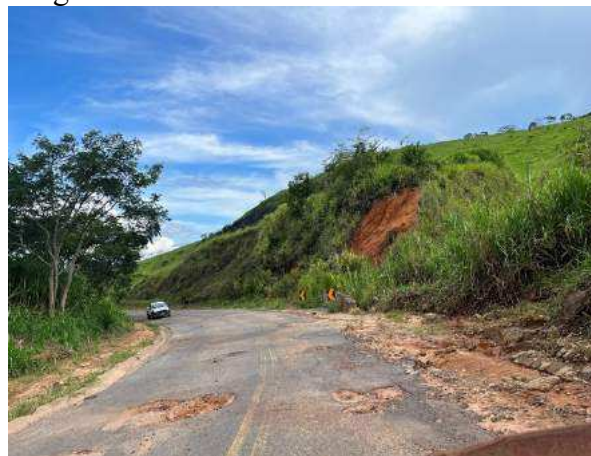
Figura 38 – Trecho com diversos buracos na chegada à Pedra Dourada
