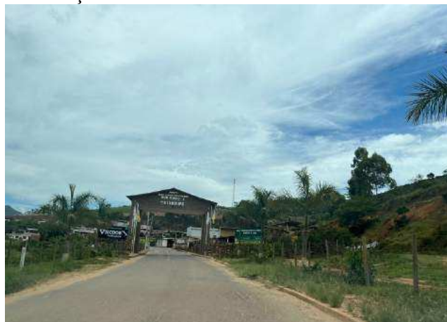
Figura 32 – Entrada de Caiana e a ausência de sinalização horizontal
