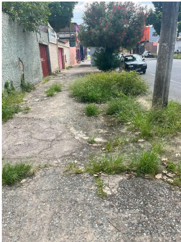
Figura 28: Situação da calçada na unidade Sagrada Família (regional Leste) do programa A Rua é Nossa
