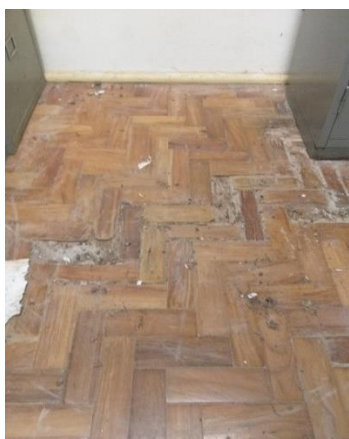
Imagem 10 - Detalhe do chão danificado pela umidade e fungos e insetos Fonte: Própria autora
