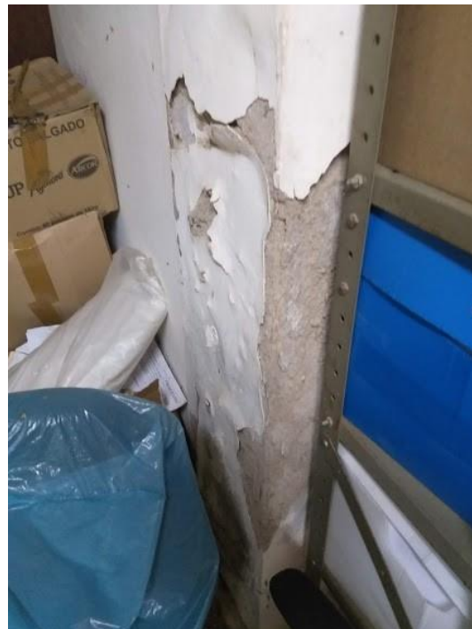
Imagem 6. Sala de depósito – Avarias na parede da sala devido à infiltração
