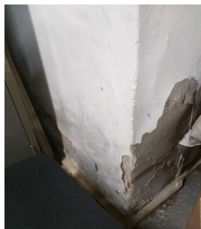
Imagem 11 - Detalhes de parede com infiltração na sala do subsolo Fonte: Própria autora
