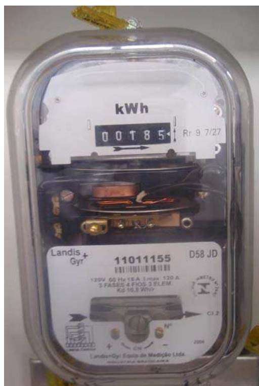
Figura 23 – Medidor de Energia Elétrica Trifásico do tipo indução
