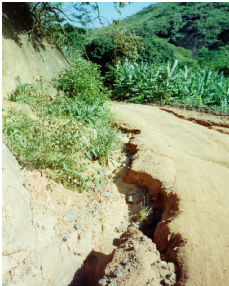
Figura 8 – Erosão da estrada na microbacia do córrego do Oratório. O carreamento de sedimentos é elevado.
