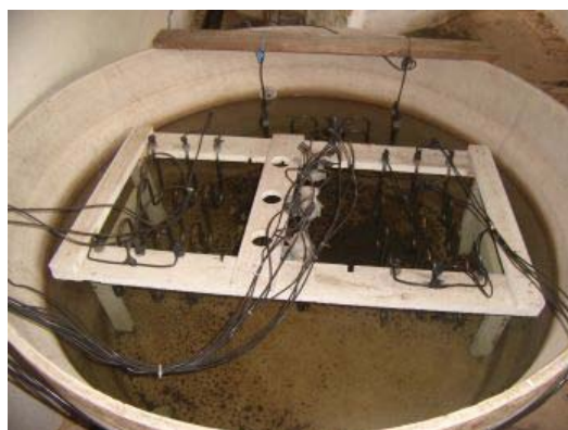
Figura 6. Conjunto para dissipação da energia elétrica do GG 2.
