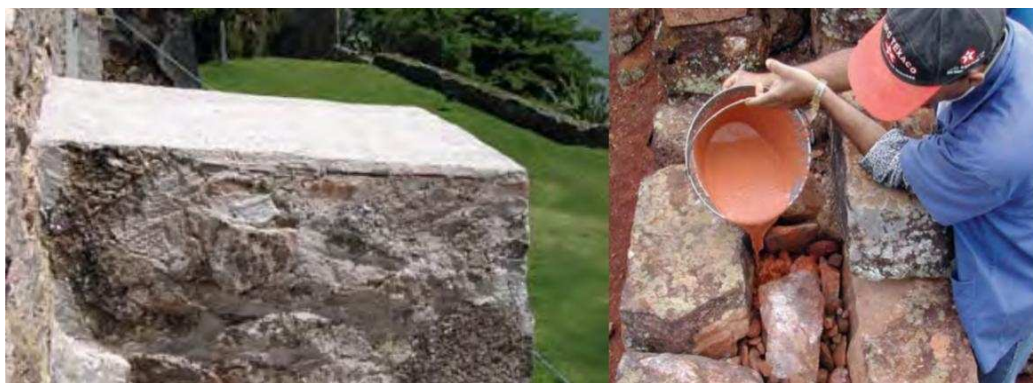
Figura 3.2 – Argamassas de cal aplicadas em capeamentos de alvenarias e em preenchimento de vazios em parede
