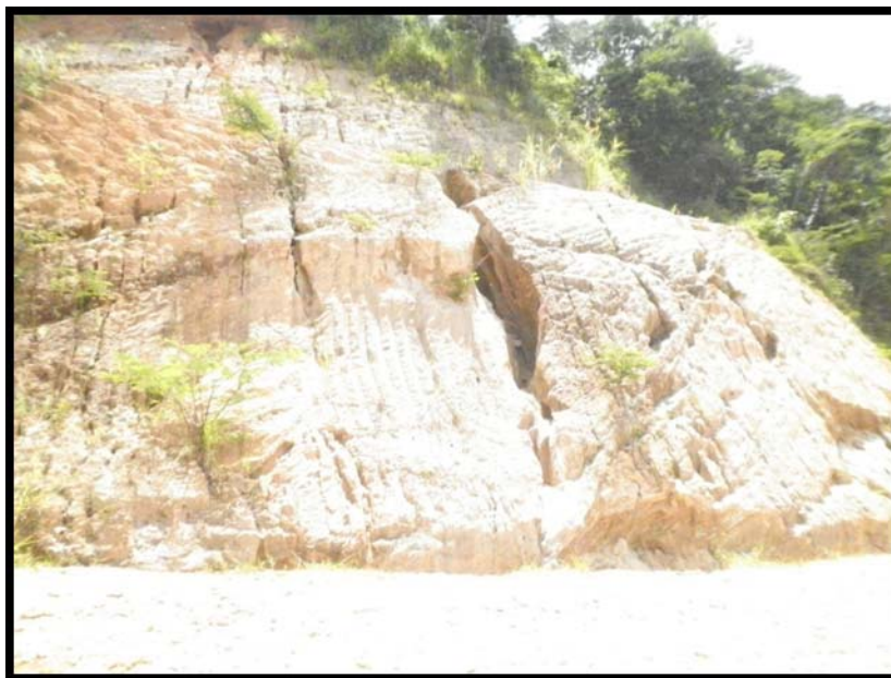
Ilustração 12 - Erosão 2 estradas de acesso às granjas. Fonte: Dados da pesquisa, 2012.
