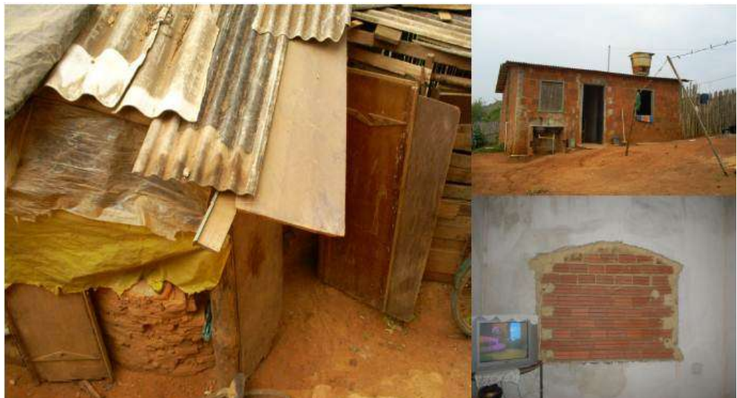
Figura 38 - Detalhes da precariedade das edificações no Bairro Nova Viçosa. Fonte: (TALIN et al, 2009).
