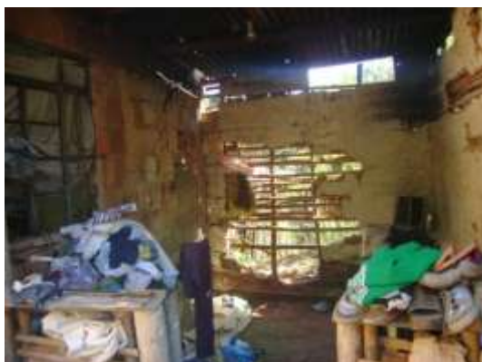
Figura 40: As condições precárias de uma das moradias das famílias atendidas pelo “Projeto HABITAT de Ação Imediata em Viçosa/MG”.
