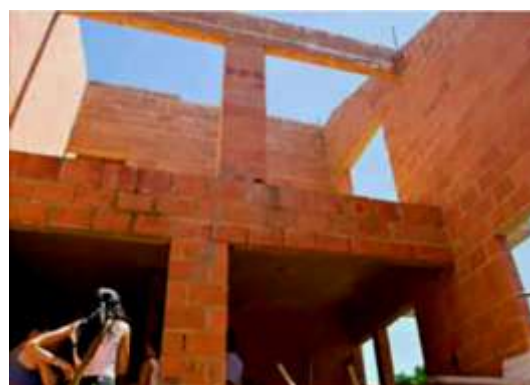
Figura 19 - Vista parcial interna da obra de uma moradia situada em Paulínia/SP. Fonte: http://www.arquitetasdacomunidade.org.br/ , 2006.
