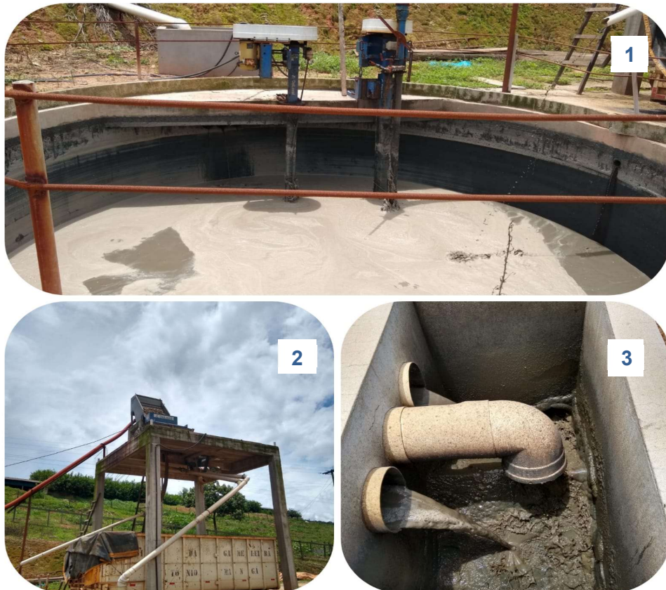
1. Tanque de equalização; 2. Peneira de separação de sólidos grosseiros; 3. Ponto de distribuição do efluente.
