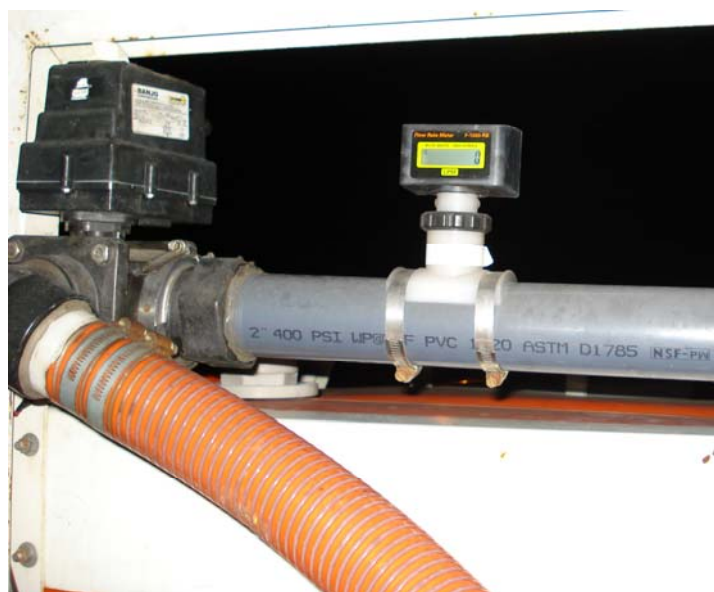
Figura 52 – Visor de vazão do sistema de aspersão
