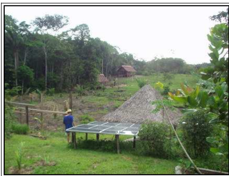
Figura 6 – Conjunto de placas solares para fornecimento de energia elétrica
