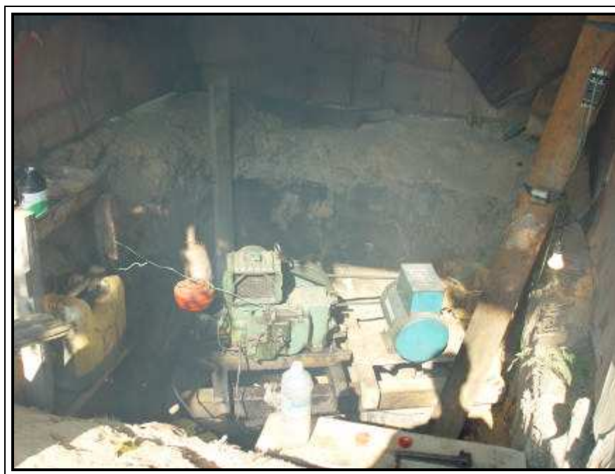
Figura 10 – Grupo gerador movido a diesel, localizado em área residencial da Vila Céu do Mapiá, responsáveis pela emissão de gases poluentes e elevados níveis de ruídos.
