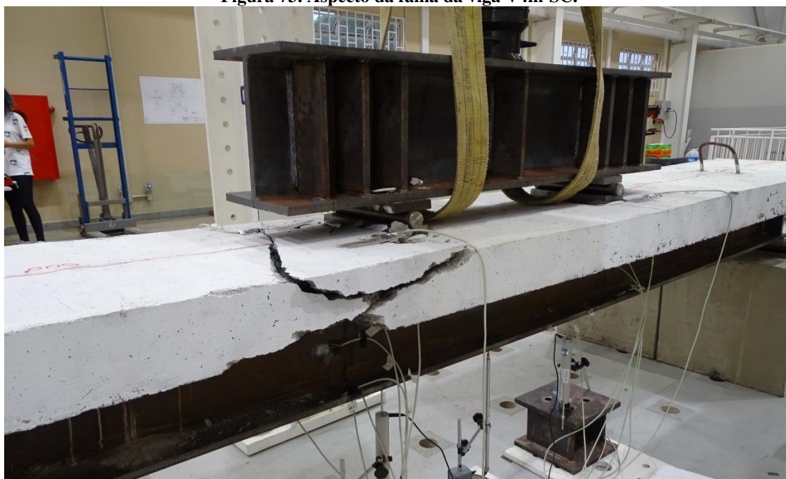
Figura 73. Aspecto da falha da viga V4m-SC.
