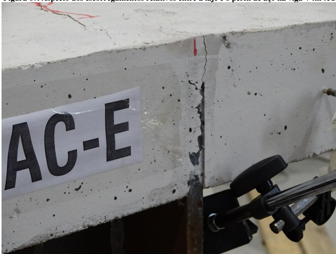
Figura 67. Aspecto dos escorregamentos relativos entre a laje e o perfil de aço na viga V4m-AC.
