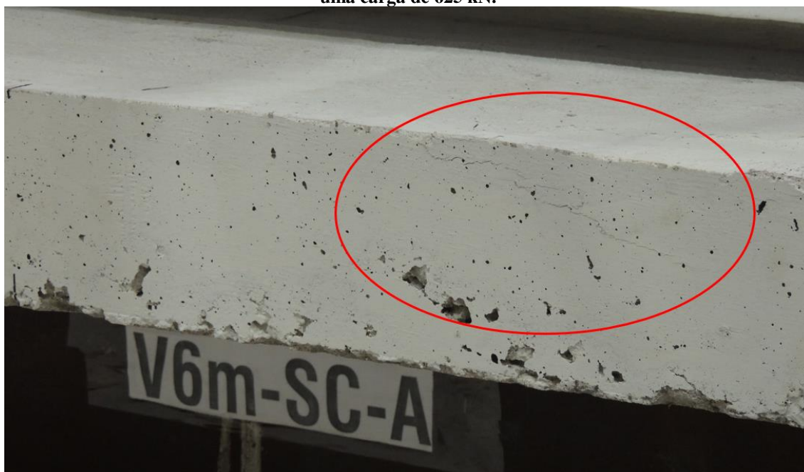
Figura 117. Fissura na face lateral anterior da laje, próxima ao ponto de aplicação de carga à direita, para uma carga de 625 kN.
