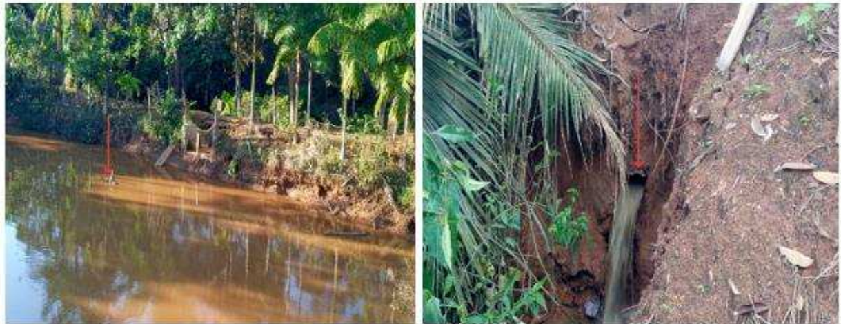
Figura 4. Tomada de fundo em uma pequena barragem de terra localizada em uma microbacia hidrográfica na comunidade Fartura no município de São Miguel do Anta, Minas Gerais, Brasil. Fonte: Próprio autor.
