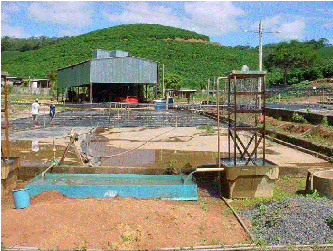
Figura 2 – Sistema de aeração e decantação do tratamento T3.
