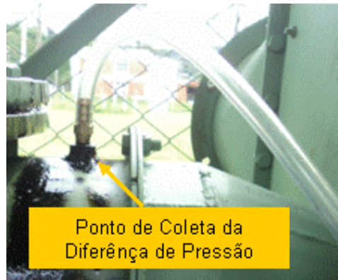
Figura 30 - Ponto de tomada da diferença de pressão.
