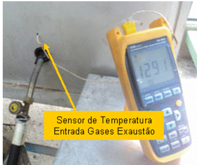
Figura 28 - Ponto de coleta da temperatura da chama do queimador da câmara de combustão secundária.
