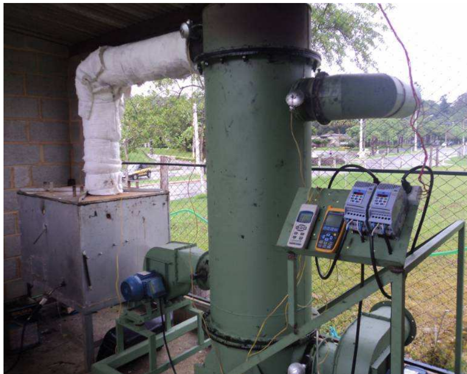
Figura 23 - Recuperador de calor acoplado ao incinerador.
