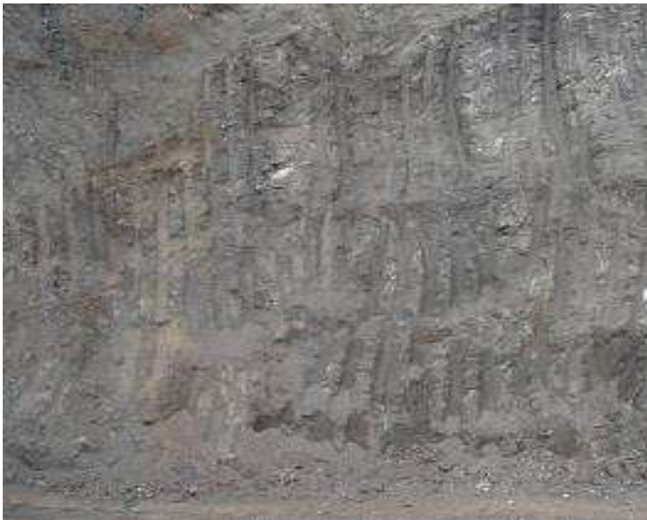
Figura 18 – Talude em Itabiritos Friáveis Argilosos (IFA) (VALE, 2008)
