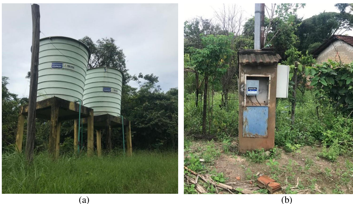
Figura 8 – Sistema de reservação e distribuição de água da comunidade de Cachoeira de Almas do município de Florestal – Minas Gerais, em que: a) reservatórios d’água; e) bomba de abastecimento
