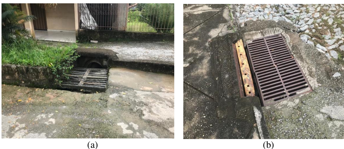
Figura 16 – Condições do sistema de manejo de águas pluviais da comunidade de Cachoeira de Almas do município de Florestal – Minas Gerais, em que: a) boca de lobo combinada; e b) boca de lobo grelha simples
