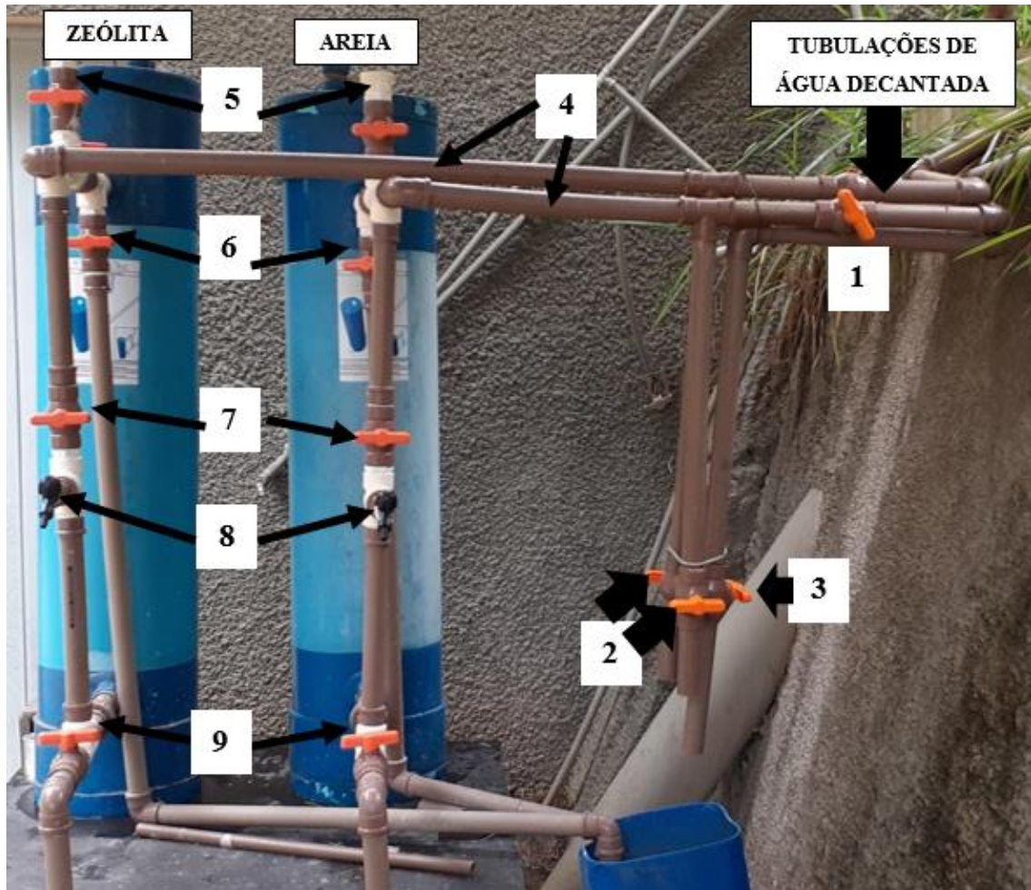
Figura 8 - Sistema de registros para: (1) controle e ajuste da vazão/taxa de filtração; (2) ponto de medição de vazão e coleta de água decantada; (3) descarte do lodo de fundo; (4) tubulação de entrada de água decantada nos filtros; (5) ponto de encaixe dos dosadores para ensaios de desinfecção pré-filtração; (6) saída da água de lavagem; (7) entrada da água de lavagem; (8) ponto de coleta de água filtrada; (9) saída de água filtrada.
