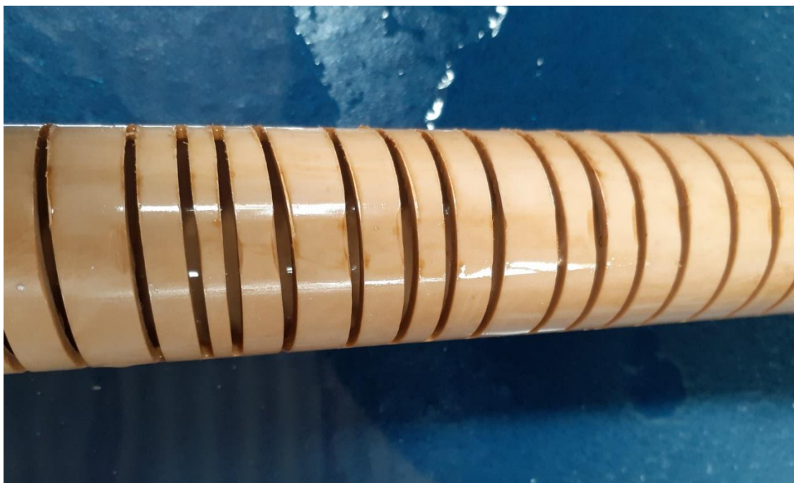
Figura 71 - Tubulação suja dentro do tanque de contato após o filtro de areia.
