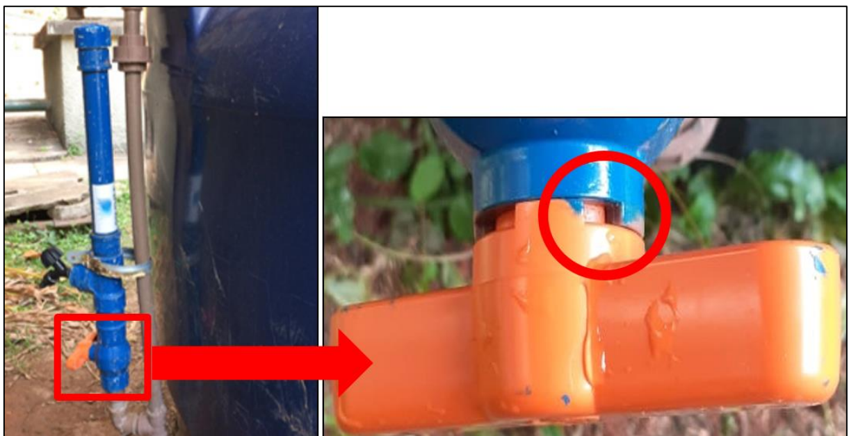
Figura 10 - Dosador de coagulante acoplado à tubulação de entrada de água bruta (esquerda) e detalhe da restrição de abertura do registro do dispositivo (direita).
