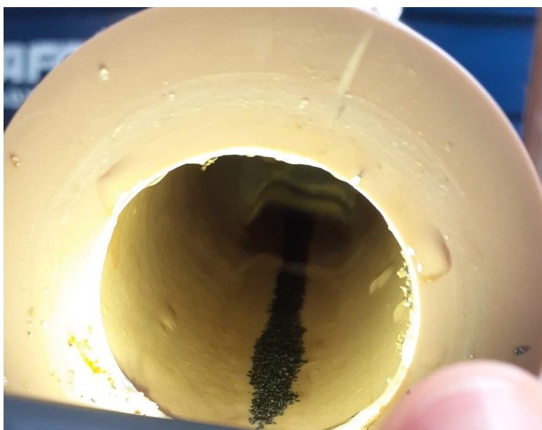
Figura 69 - Acúmulo de zeólita na tubulação de saída de água filtrada.
