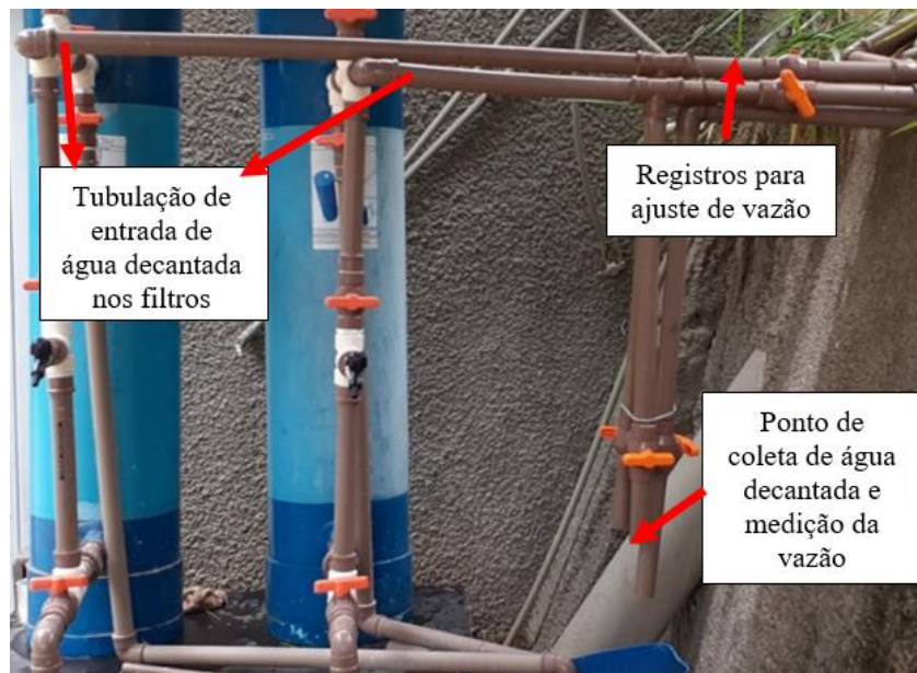
Figura 15 - Sistema de tubulação dos filtros destacando os registros para ajuste de vazão, o ponto de coleta e medição de vazão e a tubulação de entrada de água decantada nos filtros.
