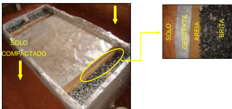
Figura 3.27 – Reservatórios preenchidos com materiais granulares e solo compactado para escoramento das paredes de graute.
