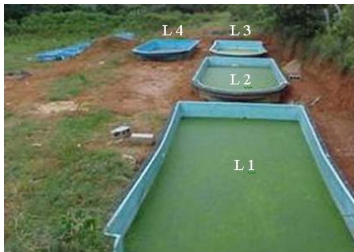
Figura 6 - Sistema de lagoas de polimento, Unidade Integrada de Tratamento de Esgotos e Utilização de Efluentes da Violeira (Viçosa, MG).
