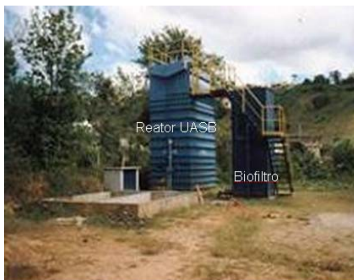
Figura 5 - Reator UASB e biofiltro aerado submerso, Unidade Integrada de Tratamento de Esgotos e Utilização de Efluentes da Violeira (Viçosa, MG).
