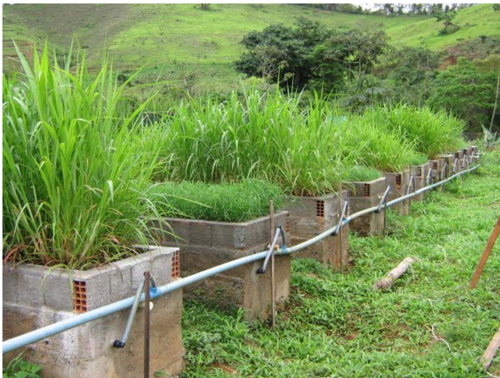
Figura 2: Vista geral do sistema de drenagem e rede coletora do efluente dos SACs.
