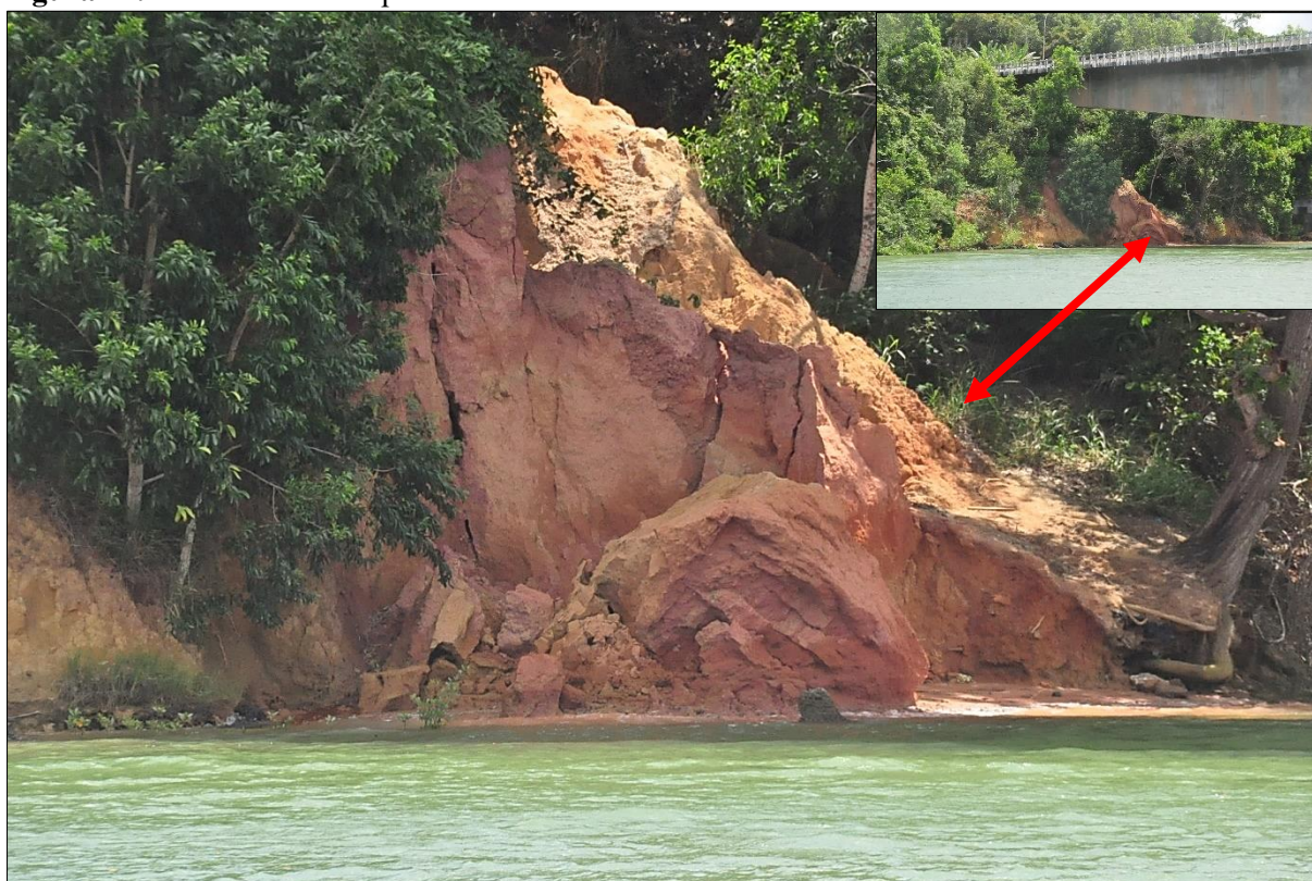
Figura 22: Erosão abaixo da ponte de Santa Cruz - Aracruz.
