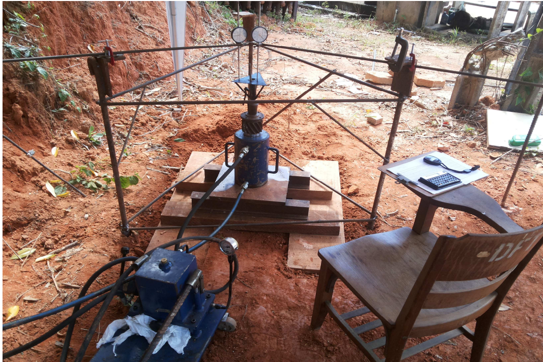
Figura 3.11 – Vista geral de todo o sistema montado
