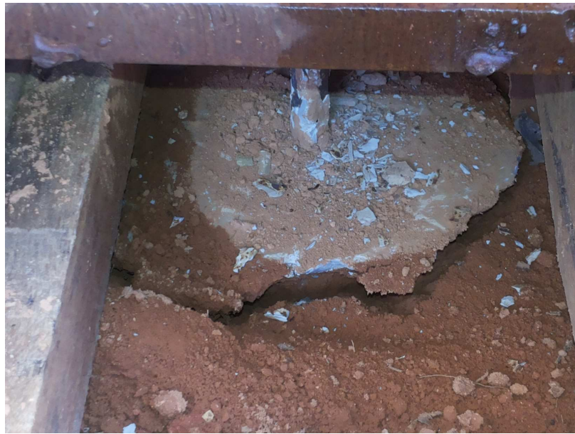
Figura 3.17 – Rompimento do sistema solo-estaca
