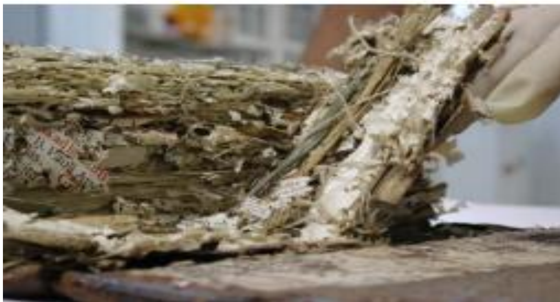
Figura 83 – Ação devastadora dos insetos xilófagos, com danos que comprometeram o manuseio
