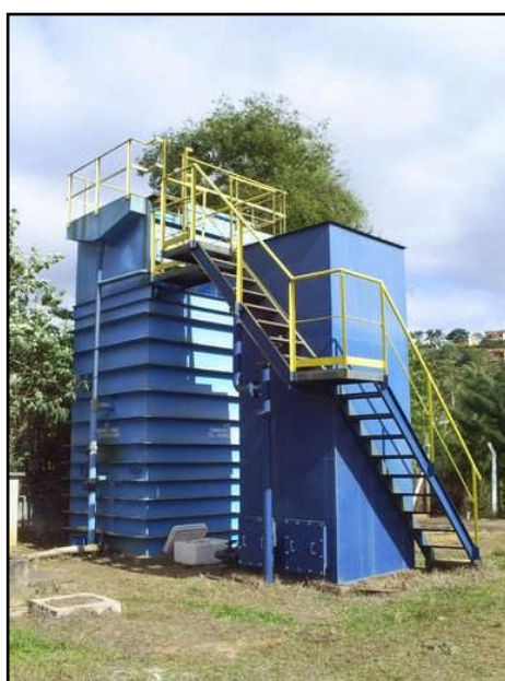
Figura 8 - Vista do sistema de tratamento de esgotos: reator UASB e biofiltro aerado submerso.
