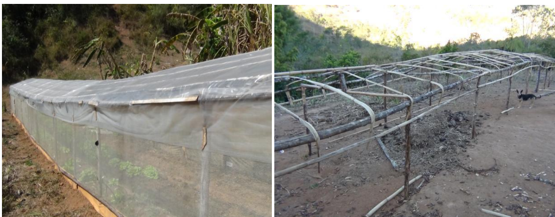
Figuras 13 e 14. À esquerda, estufa já montada e produzindo hortaliças. À direita, estrutura da estufa ainda em construção, na localidade de Emboque. Autora: Aline G. Delesposte, 2011.
